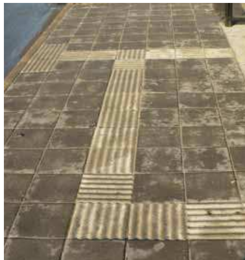
Porsgrunn. Detalj av ledelinjer og belegg på holdeplass. Kontrasten mellom ledelinjene og de andre hellene burde ha vært større og oppmerksomhetsfeltet dypere. Foto: Ragnar Grøsfjeld.
